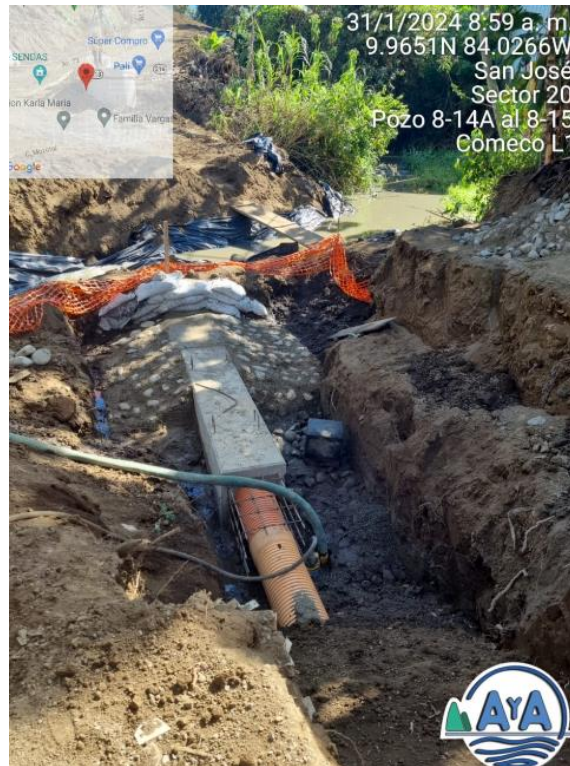
Imagen #16. Colapso 8-13 y 8-15 atendido
