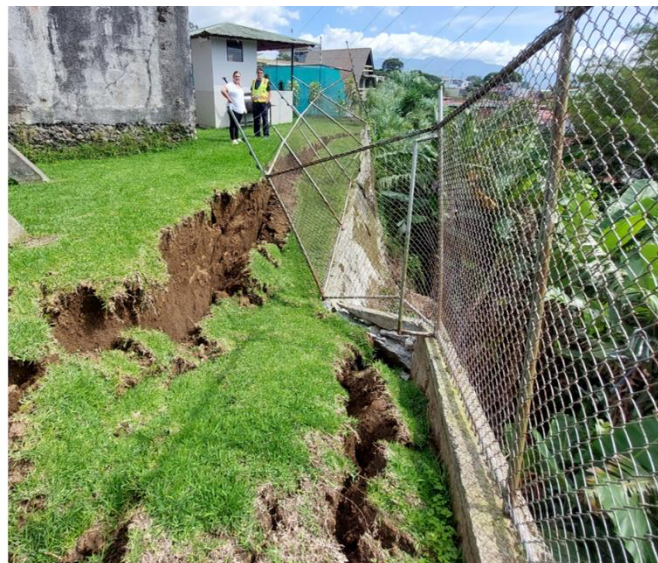
Imagen #7. Colapso de muro propiedad privada
