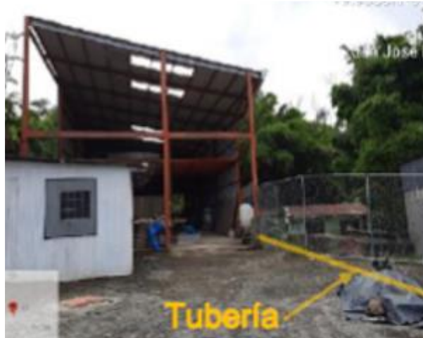
Imagen #6. Presencia de edificación en trazado de tubería a instalar
